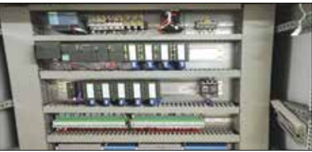
تابلوی PLC نصب شده پس از اجرای پروژه
