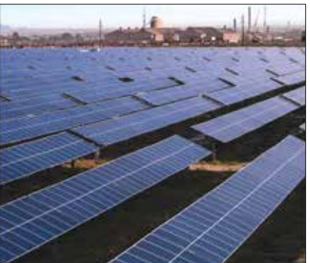
شکل ۲- مزرعه خورشیدی ۳۰۰ مگاواتی بیگ‌هورن در کنار کارخانه فولادسازی
