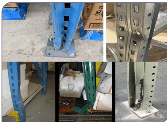
شکل ۴-۶. برخی از عیوب پایه‌های قفسه‌ها
